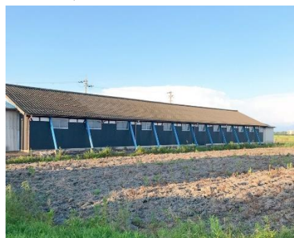
図1 かつての作業場とされる建築物鉄骨の斜材が飛び出している(撮影は筆者による)
